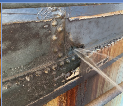
DANO MECÂNICO, TRINCA, AMASSADO, SABOTAGEM
